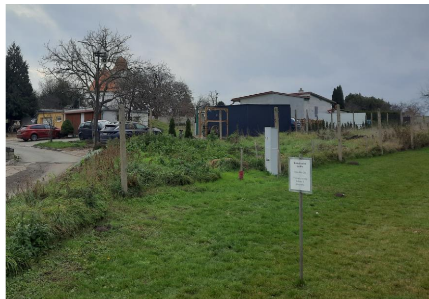
Pozemek č.1 přípojková skříň, VO, a označení kanalizační šachty.
