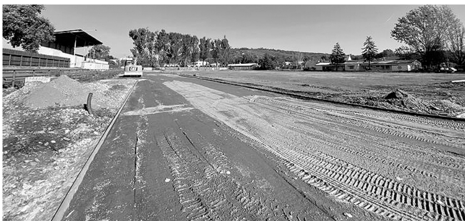
Špičkové sportovní zázemí si už na jaře budou moci vyzkoušet nejen sportovní oddíly, ale i široká veřejnost.
