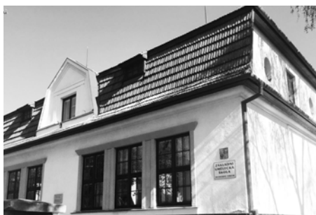
Střechu ZUŠ čeká oprava.
