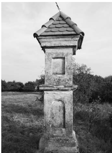
Stav před opravou
