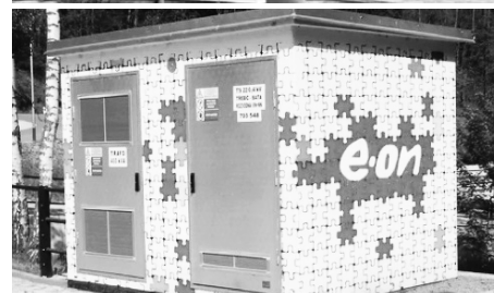
Podobnou trafostanici budou mít i Hustopeče.
